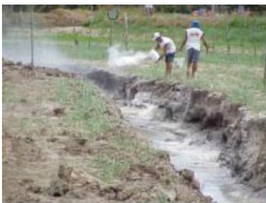
Fig. 34. Aplicação de cal virgem sem equipamento de segurança.
