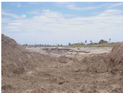
Fig. 2. Desmoronamento do talude de viveiro.
