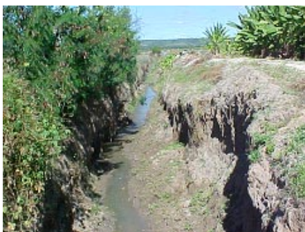
Fig. 7. Erosão no canal de descarga.
